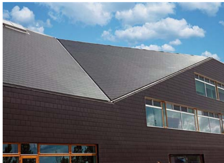
Hillerød Rådhus. Her samles tag og facade i et, fordi skiferbeklædning af fiberce-ment er den samme på både tagflade og facade. Materialet er forholdsvis vedlige-holdelsesfrit og modstandsdygtigt overfor råd og svamp.
